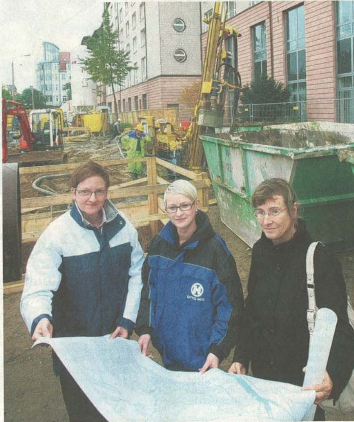
Auf der Baustelle (von links): Katja Gläß, Bauleiterin Martha Simon und Cornelia Nietzschmann mit einem Plan des Abwasser-Netzes. Foto: Andre Kempner
