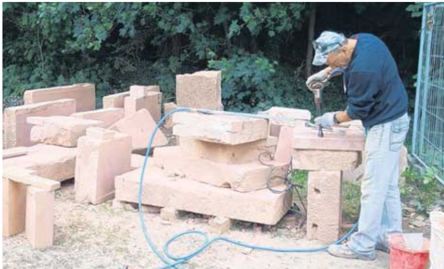
Akribische Kleinarbeiten: Mitarbeiter der Firma P.N. Bau- und Restaurierung GmbH bereiten die Porphy-Steine für die Verkleidung des neuen Pfeilers vor. Foto: Silke Hoffmann
