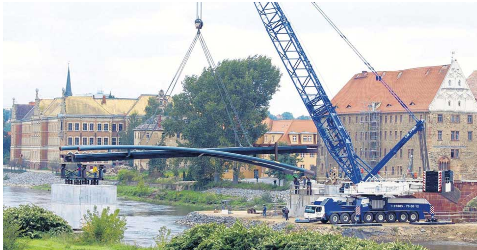
Riesenkran und filigrane Arbeit: Die erste Hälfte der neuen Grimmaer Muldebrücke wurde gestern punktgenau auf die Pfeiler aufgesetzt.
