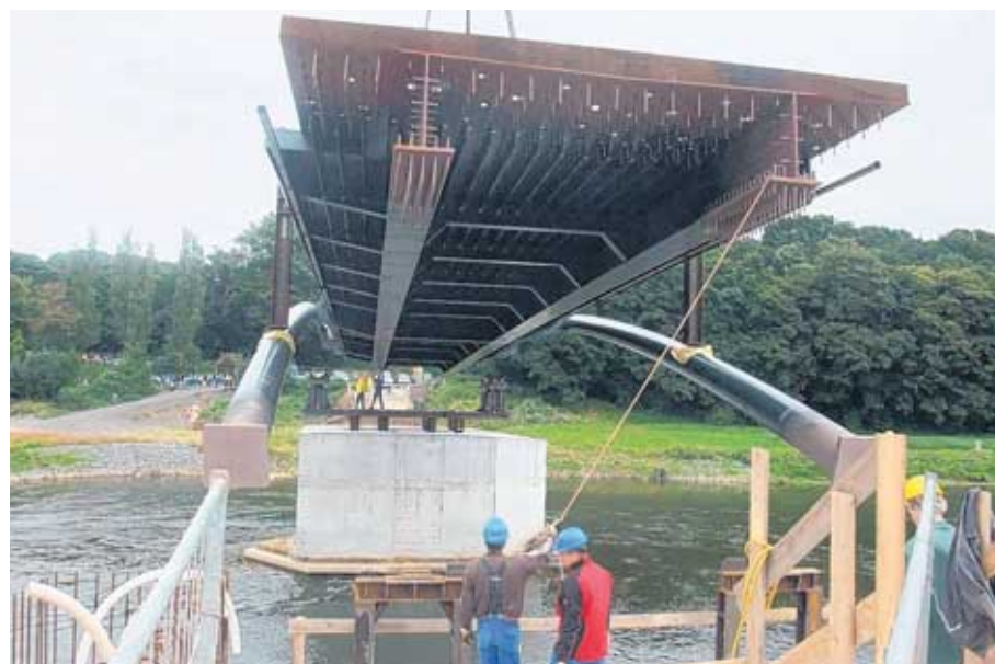
Wird noch per Hand in die richtigen Bahnen gelenkt: Das 37,5 Meter lange Brückenteil kurz vor dem Aufsetzen auf den beiden Pfeilern. Foto: Silke Hoffmann
